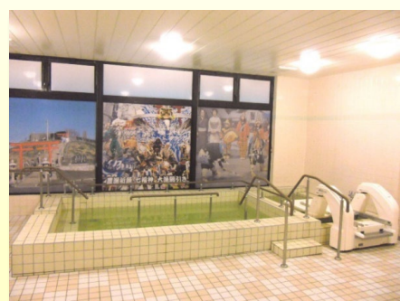
大浴槽、座位リフト浴槽
